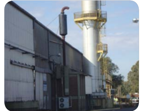
Programa Atenuación de Ruido Equipos silenciadores
